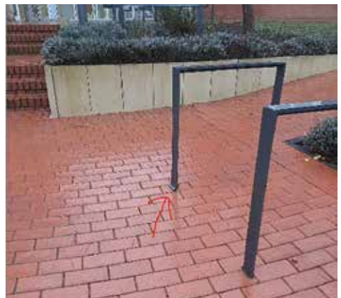
Zwischenzeitlich ist der Schaden wieder behoben worden.
